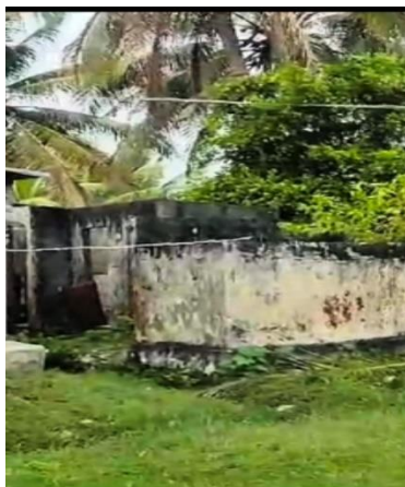
Kondisi fisik bangunan MCK Komunal, perlu perbaikan.
